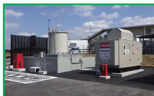
停電対策用発電機
