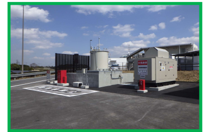
停電対策用発電機
